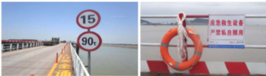
栈桥标示标牌
